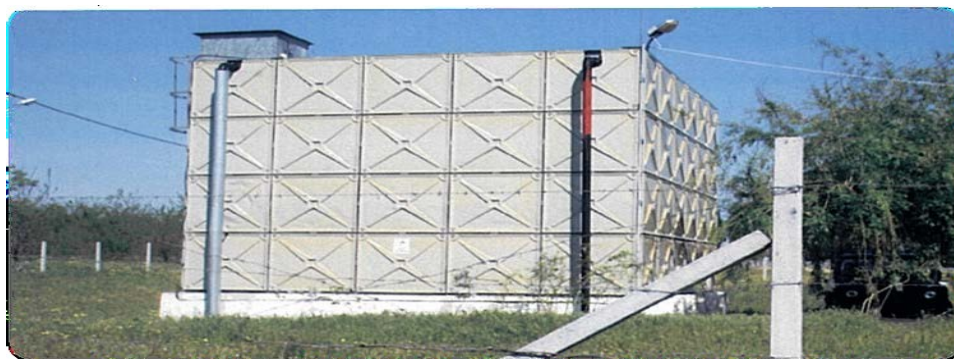
Stație de apă
